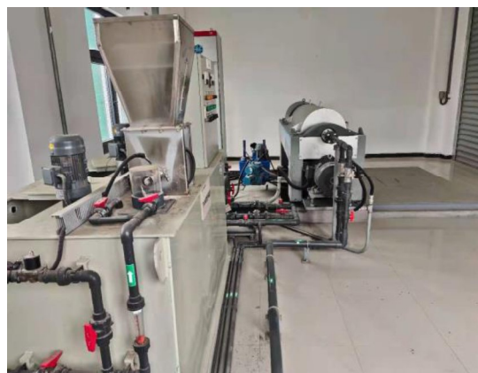
渗滤液污泥脱水系统
