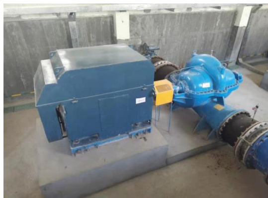
水泵、给料泵隔声降噪减震
