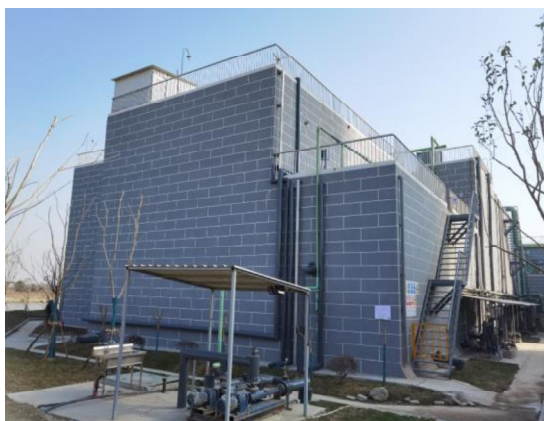
渗滤液处理系统
