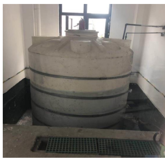
硫酸储罐及收集池
