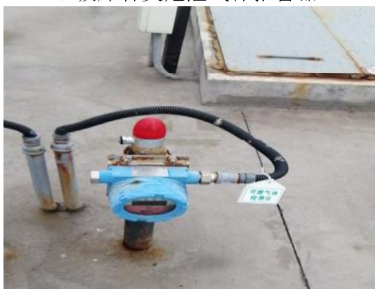
渗滤液处理站池顶可燃气体报警器
