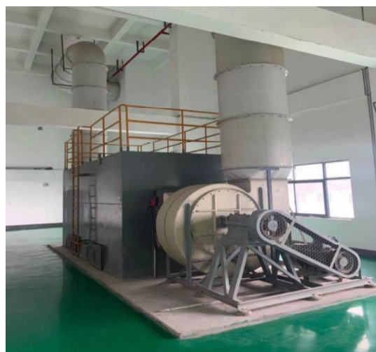
垃圾库顶部活性炭除臭系统
