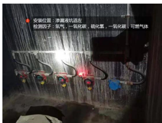
渗滤液坑道各类危险气体报警器
