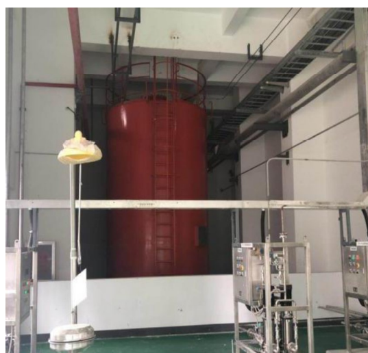
氨水储罐及围堰
