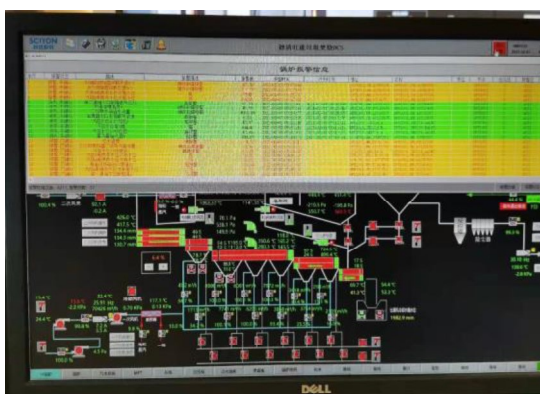
锅炉报警系统
