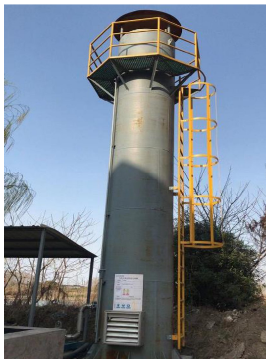
火炬燃烧装置
