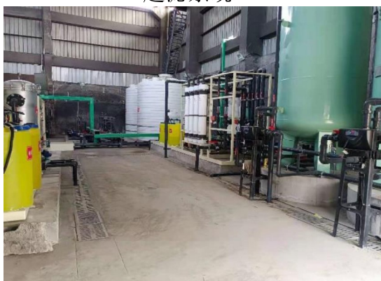
减湿废水处理系统
